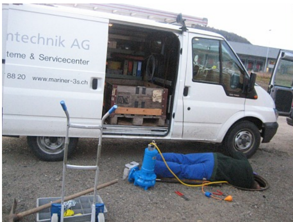
Montage der Pumpe und Niveauregler durch den 3S Service
